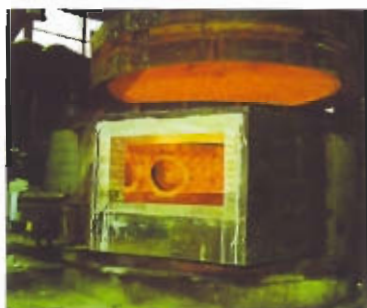
Огнеупорная футеровка алюминиевой плавильной печи.
