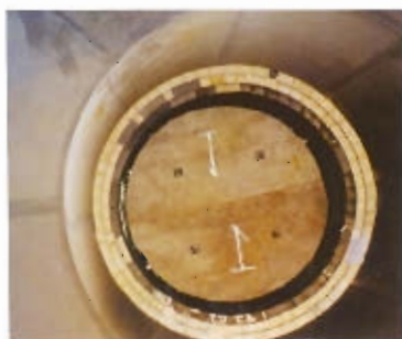
Луминирование и трехслойная футеровка в башне Вентури.
