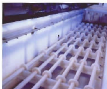
Смонтированный с учетом воздействия плавиковой кислоты резервуар из полипропилена со встроенными деталями из поливинилдафторида.
