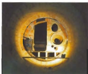
Вращающийся барабан установки для сжигания остаточных веществ с видом на торцевую стенку с полной футеровкой.
