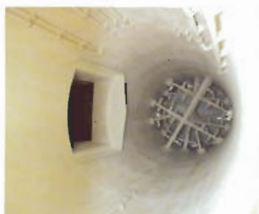
Конструкция промывочной бетонной емкости на установке для обескислороживания дымовых газов с механически закрепленной футеровкой из полипропилена.
