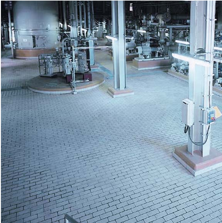
Großflächige Abdichtung und Plattierung in einer Rauchgasentschwefelungsanlage.
