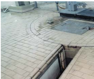
Im Fundament verankerte Thermoplastrinnen mit speziellen Detaillösungen zur Anbindung an den plattierten Industriefußboden.
