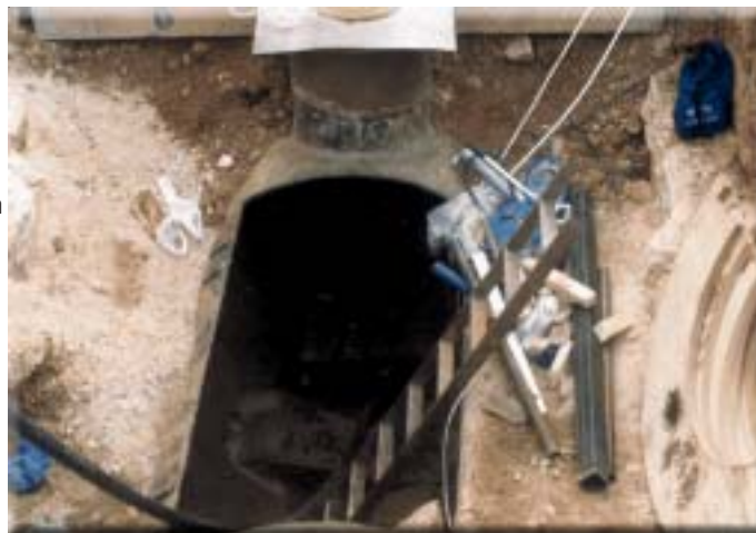
Eingang zum bestehenden korrodierten Rohr
