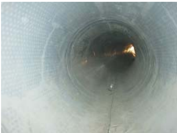
Ansicht des fertigen Rohres vor der Kommissionierung view to section of finished pipe prior to commissioning
