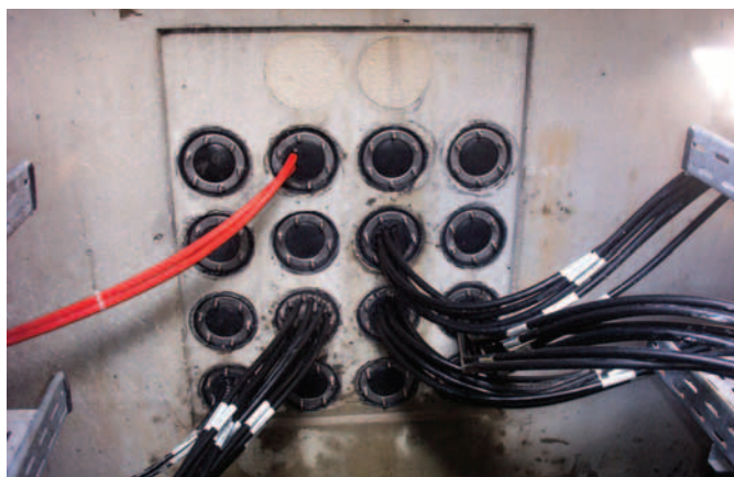
Zahlreiche Kabelverteilschächte, im Bereich der Rollwege, wurden mit UGA Gummi-Press-Dichtungen GPD abgedichtet.
